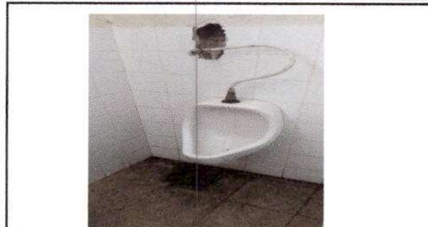
Foto 8: Sustrucción de mejitorios.
